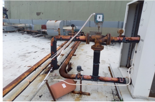
Foto 2: Condizioni di degrado delle tubazioni
