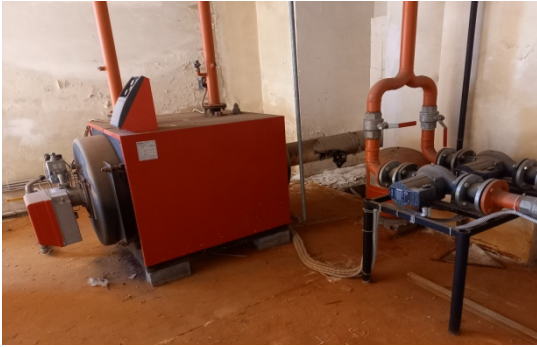
Foto 1: Caldaia a pavimento
