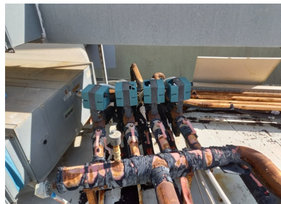
Foto 6: Collettori idrici impianto idronico
